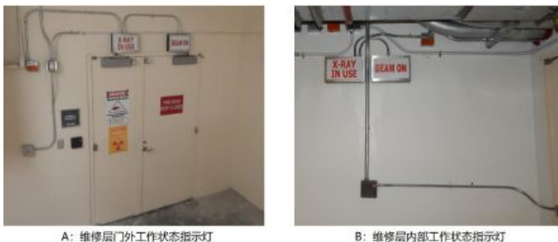
图 4-15 维修室内工作状态指示灯示例图
